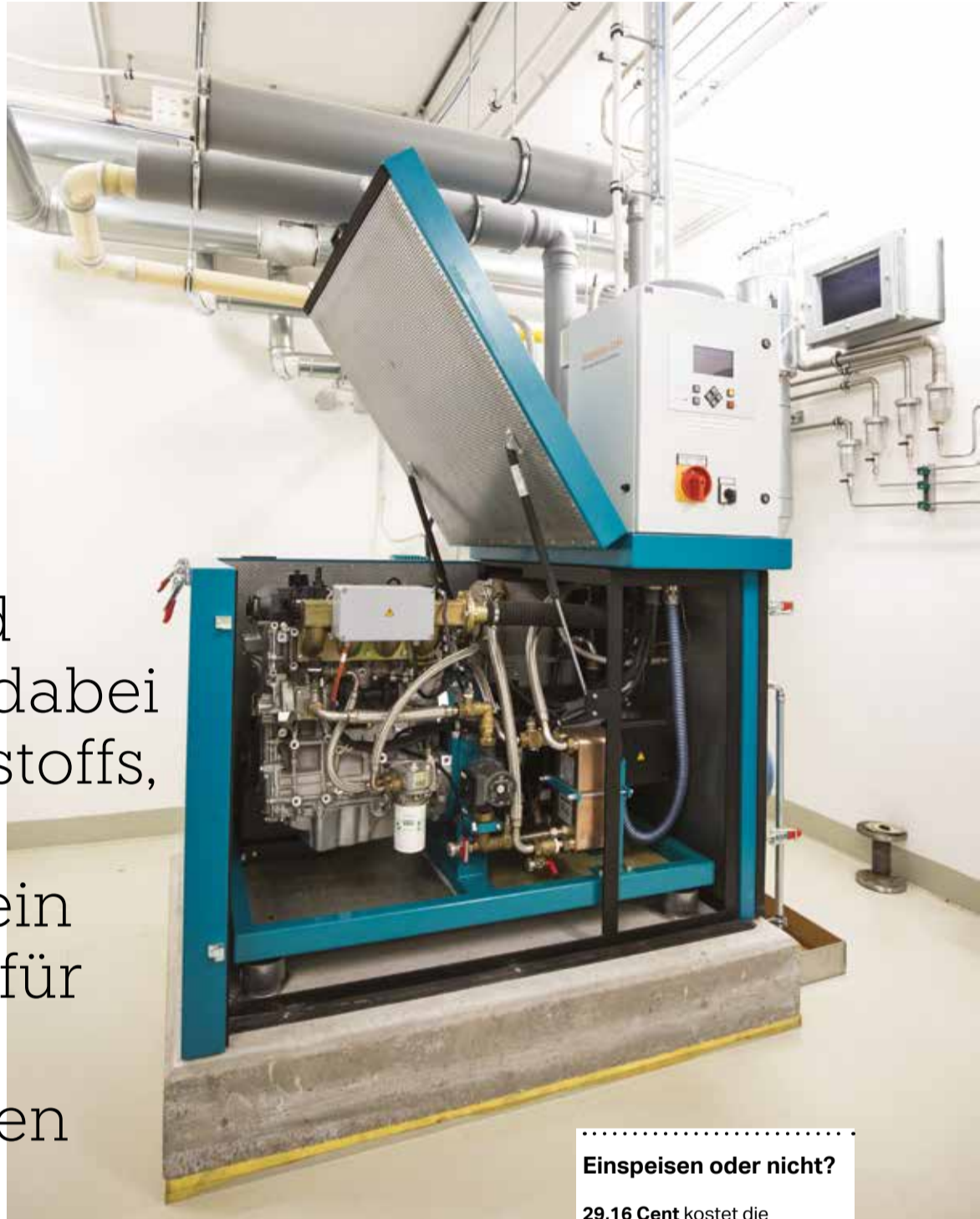
Ein mit Erdgas betriebener Ottomotor treibt einen Generator zur Stromerzeugung an: geöffnetes Blockheizkraftwerk auf dem „Energie-Campus“ der Hochschule für angewandte Wissenschaften in Hamburg-Bergedorf Foto: Christian Charisius/dpa
